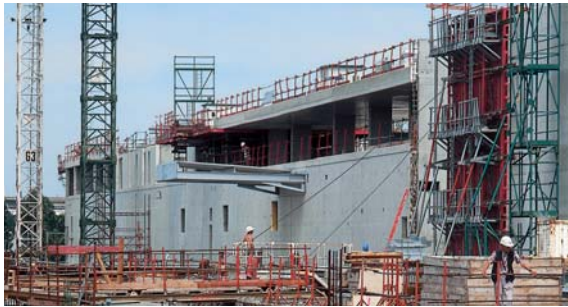
Station d'épuration de Colombes
