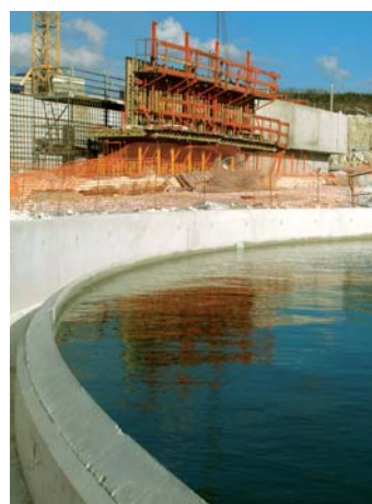
Station d'épuration - Ambonne
