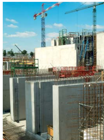
Unité de traitement des eaux usées Les Grésillons
